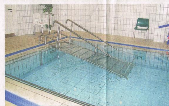
Das Schwimmtherapiebecken mit absenkbarem Hubboden. Innerhalb weniger Minuten lässt sich hier eine Tiefe von 30 Zentimetern bis zu 1,30 Meter regulieren.
